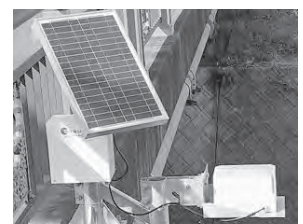
▲藤枝市内の河川設置の水位計
