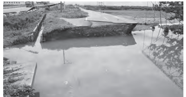
▲激流により、大きく陥没した市道 長瀬松沢線（松沢橋北側）
