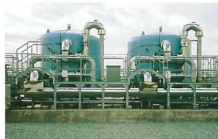
除鉄・除マンガン処理設備
