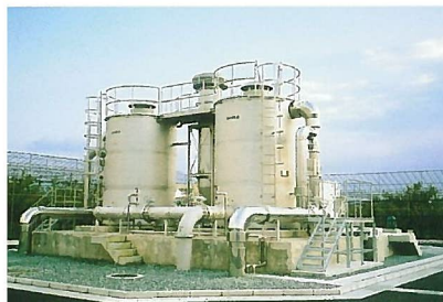
エアレーション設備
