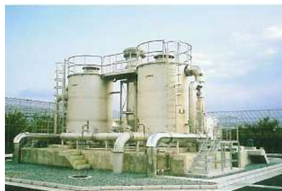
エアレーション設備
