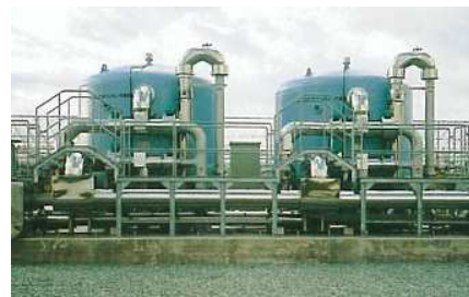
除鉄・除マンガン処理設備
